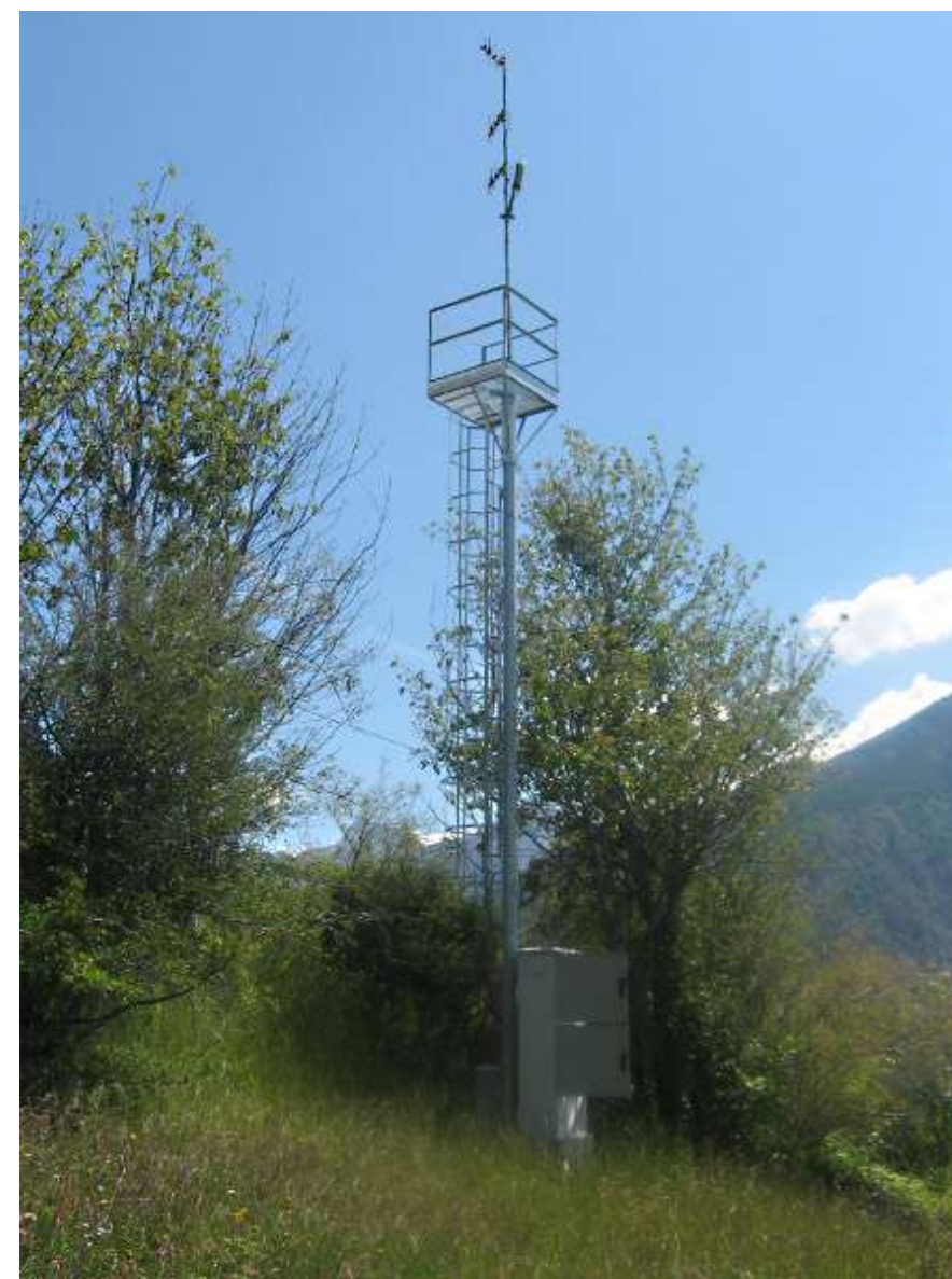
Centro telecontrollo F.Ili Ronc
